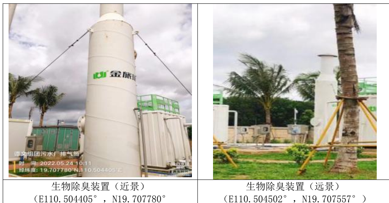
图 3-3 生物除臭装置照片
