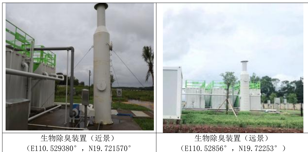
图 3-3 生物除臭装置照片
