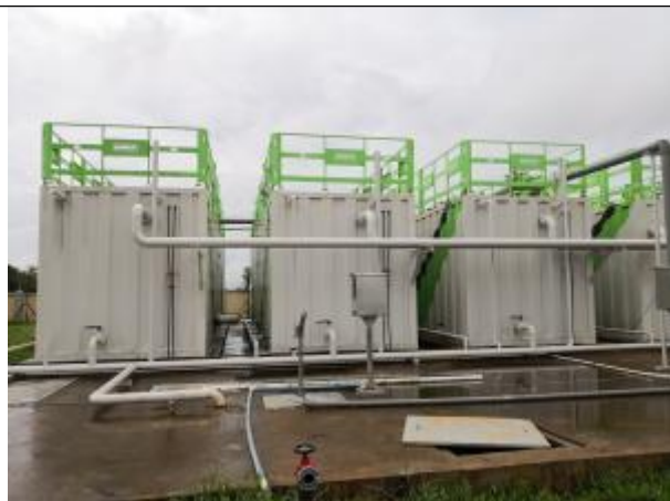
一体化装置设备均密封在箱体或地下 (E110°31'47.18947", N19°43'20.50509")
