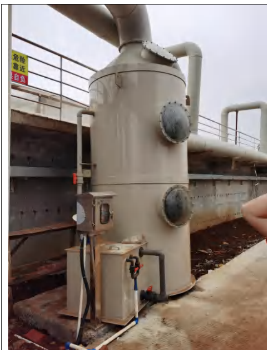
污水处理站生物除臭系统
