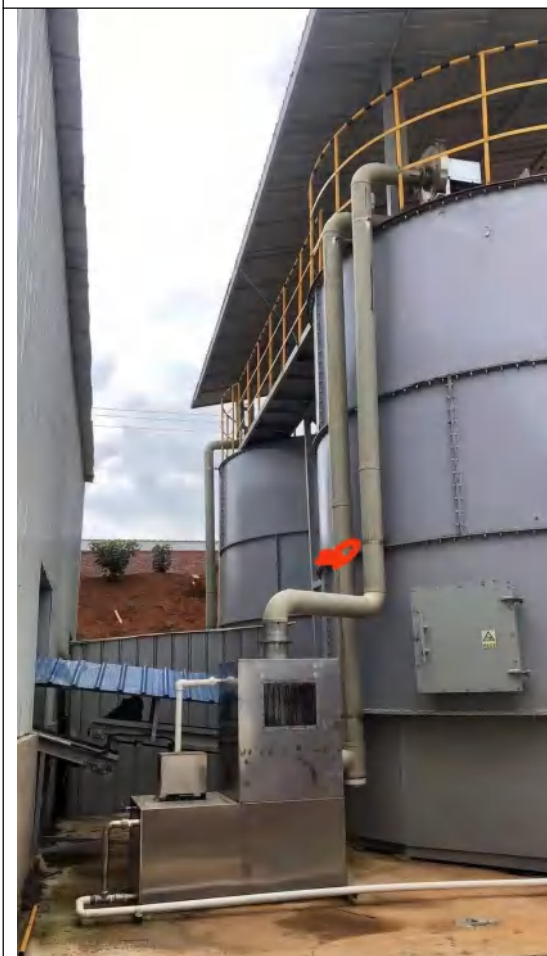
有机物发酵罐废气处理
